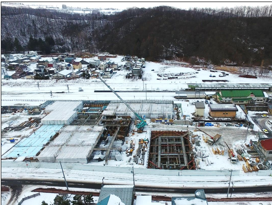
(令和2年1月24日撮影：ドローンによる上空からの工事進捗状況写真①)
