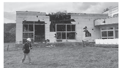
▲噴石の被害を受けた旧とうやこ幼稚園
